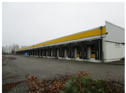
vor der Instandsetzung
